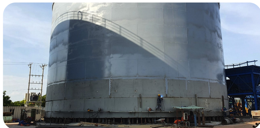
BỒN HÓA CHẤT TẬP ĐOÀN THÀNH THÀNH CÔNG
